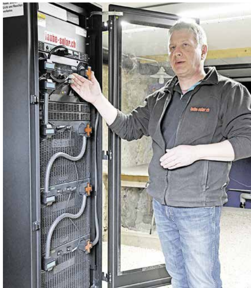
Energieberater Beat Kunz im Keller, neben der grossen Batterie.
